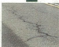
●舗装のひび割れの様子。
