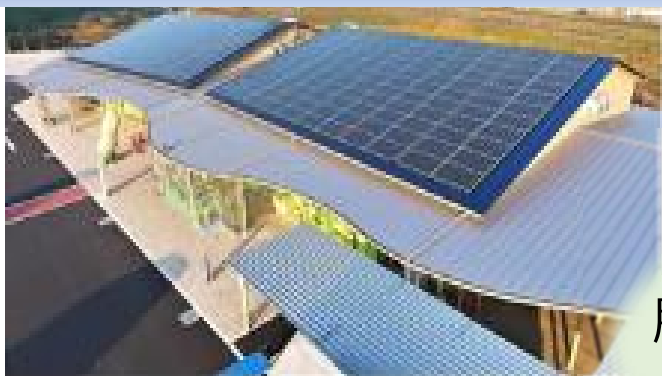
太陽光発電設備/風力発電設備
