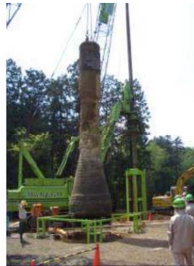
写真-1 掘り出した杭状況
