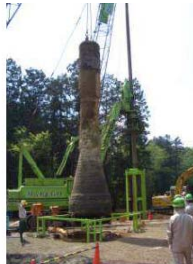
写真-1 掘り出した杭状況
