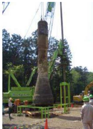
写真-1 掘り出した杭状況
