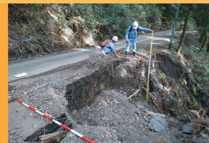
土砂崩落箇所や道路、河川の護岸などの公共土木施設の被害状況を短期間に調査。
