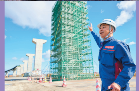
養老ICと北勢IC(仮称)を結ぶ工区の岐阜県海津市南濃町地内。完成を目指し、着々と作業が進んでいる。
