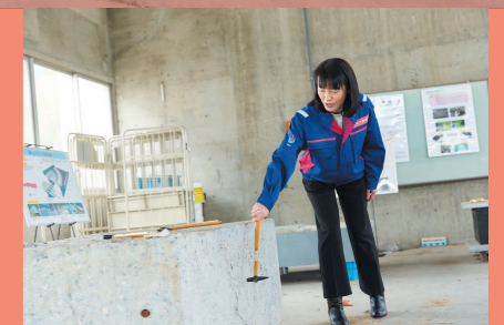
センター内に保管されている、劣化した橋梁の部材。点検ハンマーで叩いた時の音の高低差などで損傷の有無を確認でき、講習などに活用。
