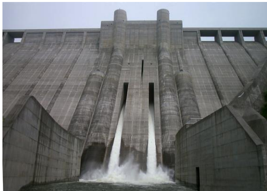
ダム放流設備（ゲート）
