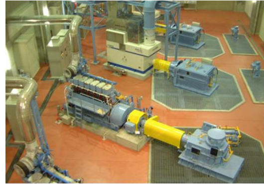
排水機場（ポンプ）
