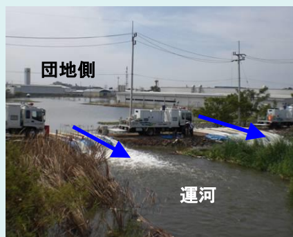
排水状況全景
