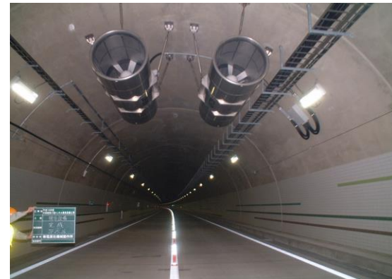
トンネル換気設備（ジェットファン）
