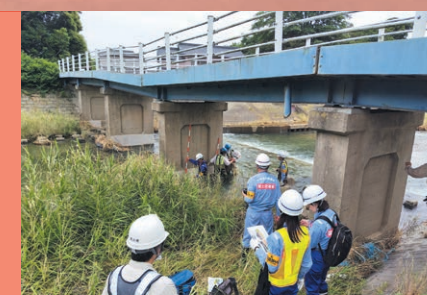
市道の橋脚が大雨で沈下して上部構造に変状が見られた際などには、要請に応じて、中部地方整備局の職員が現地に赴き、復旧の技術的助言などを実施。
