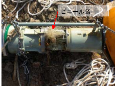
ポンプへのゴミのつまり状況
