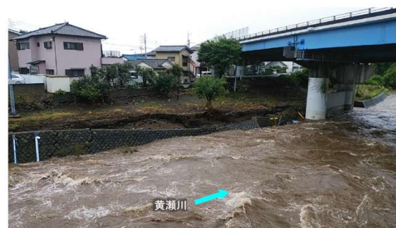
黄瀬川左岸 ブロック積護岸の崩落
