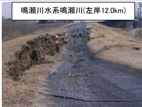
平成23年(2011年)東北地方太平洋沖地震による堤防の被災状況
