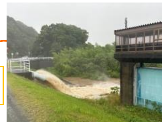
小坂排水機場稼働状況
