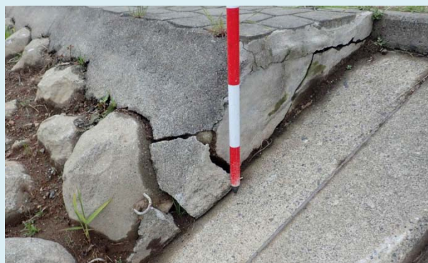
割れ目の状況
