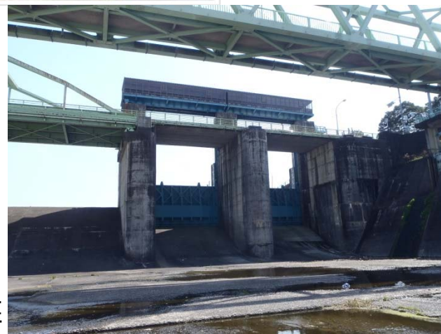
通常時の 放水路分流堰
