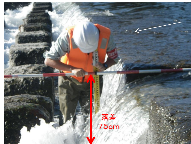
②-2 護床工と水叩面の落差
