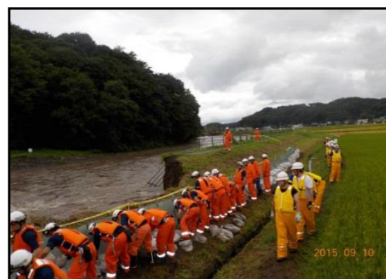
宇都宮市 田川左岸(関堀町地先) 改良積み土のう(土留鋼板使用)
