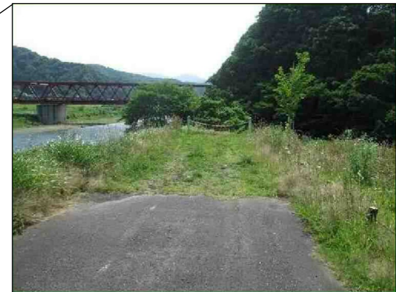
堤防道路の分断箇所 (狩野川右岸大仁橋付近)
