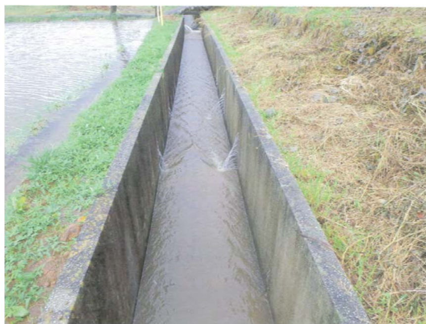
◆平成26年10月の出水における漏水状況。(狩野川左岸27.2k付近)
