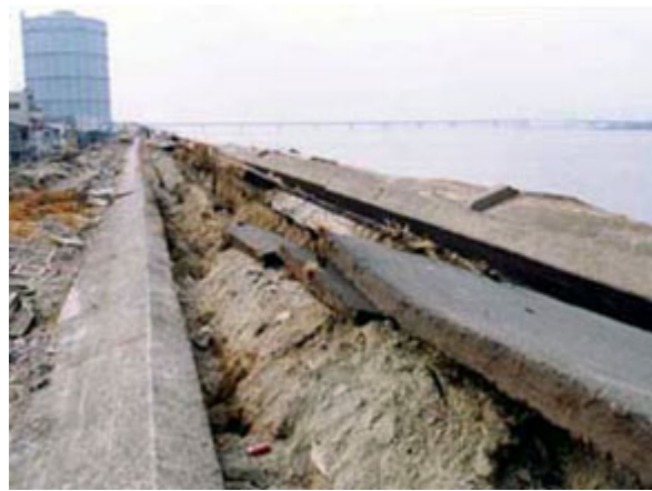
川表護岸の被災状況
