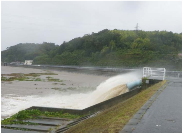
排水機場の稼働状況
