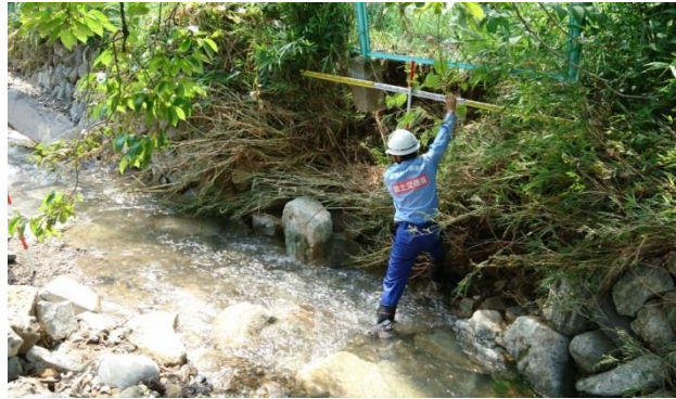
河川の被災状況現地調査 (岐阜県関市)
