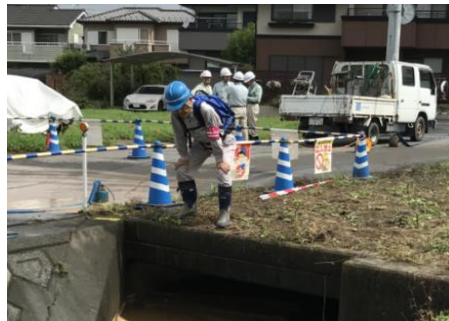
防災エキスパート 被災状況の確認
