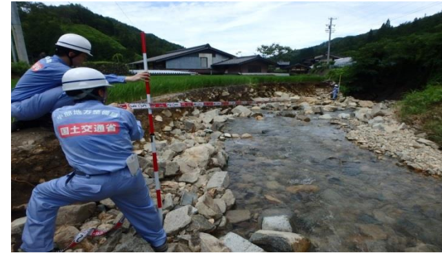
河川の被災状況現地調査 (岐阜県下呂市)
