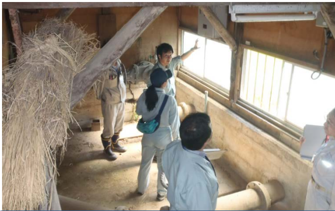
「南條用水のポンプ操作盤」を確認
