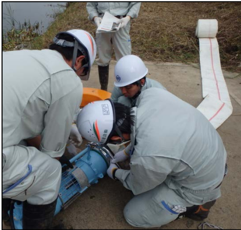
排水ポンプと排水ホースの接続
