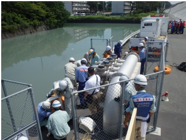
排水管に接続した排水ポンプを用水路に下ろす参加者
