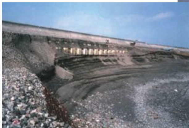
平成28年8月台風第12号。高波浪後の海岸、根固工が露出している。(No.48付近)
