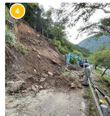
【(主)伊東西伊豆線 法面崩壊】 (2021.8 西伊豆町一色)
