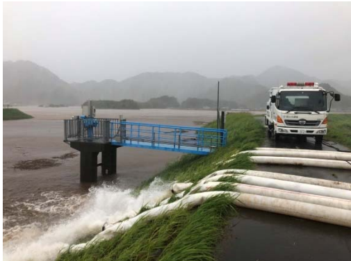
近年の排水ポンプ車稼働実績 (R1: 令和元年東日本台風(三島市御園地区))
