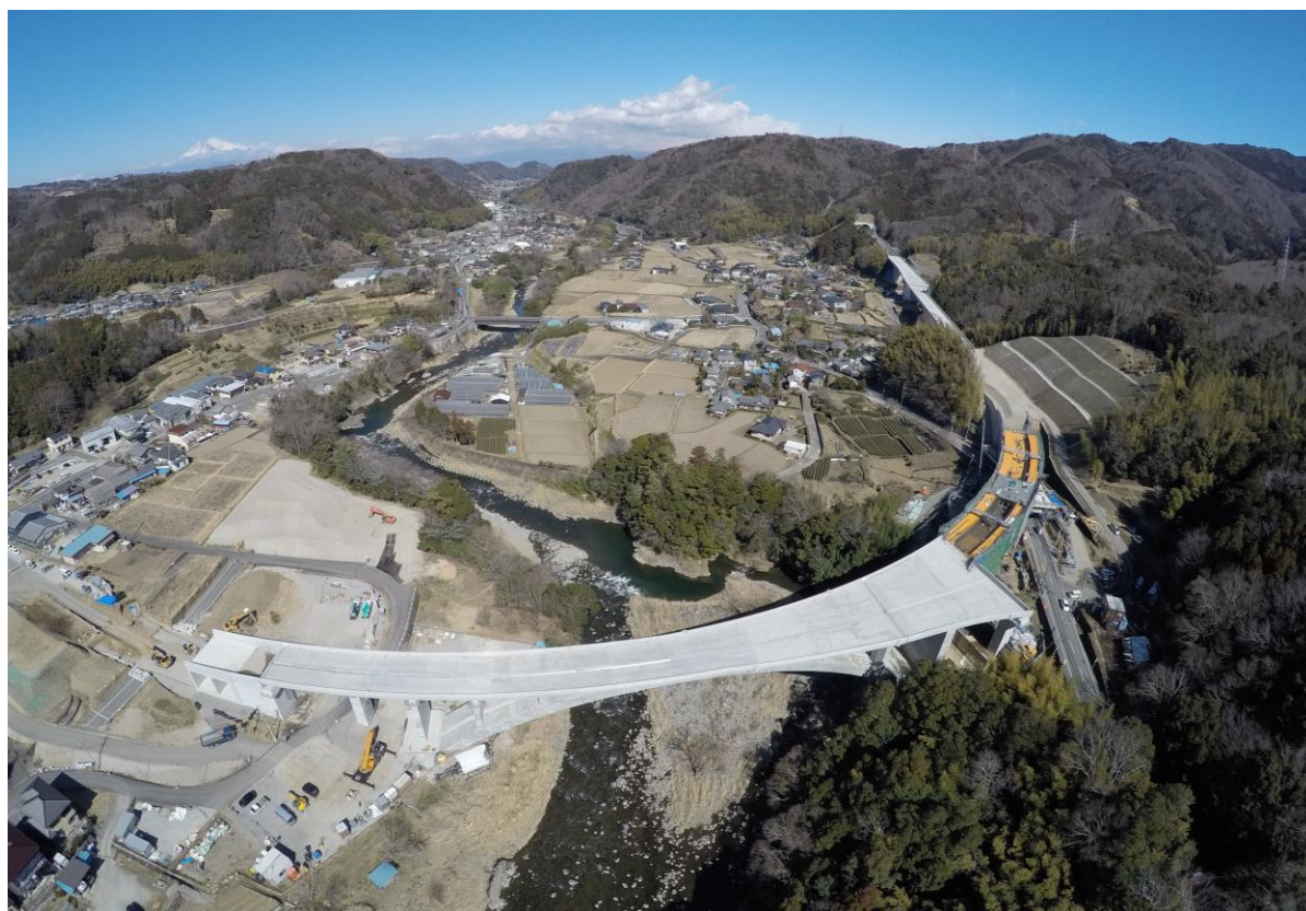
伊豆縦貫自動車道 天城北道路 天城湯ヶ島IC(仮称)付近
