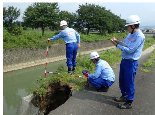
現地調査の様子(H29九州北部豪雨)
