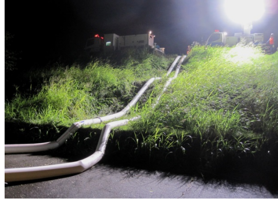
近年の排水ポンプ車稼働実績 (H23: 台風15号(函南町新田地区))
