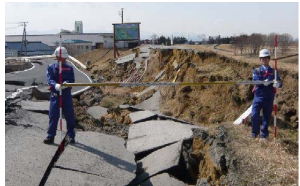
河川堤防や道路・港湾施設などの被災状況を隊員が調査
