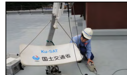
可搬式衛星通信装置の設置
