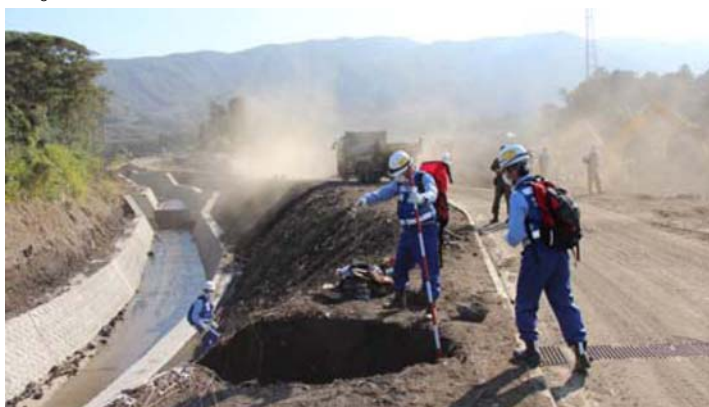
溪流保全工背後の洗掘状況を調査
