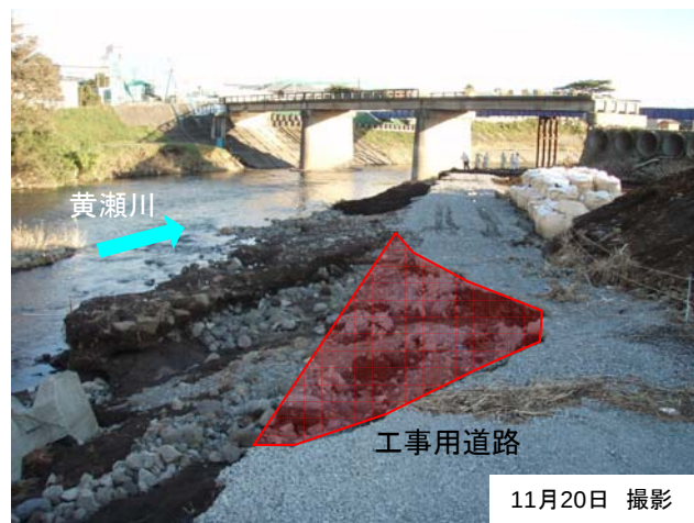
出水後の進入路被災状況(黄瀬川橋付近)
