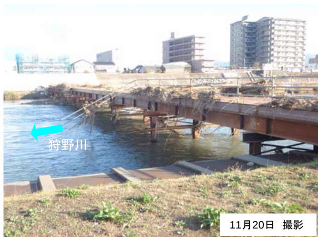
出水後の塵芥堆積状況(沼津市平町地先)
