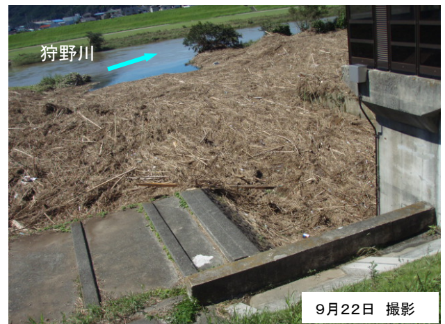
樋管水路に堆積した流木(境川排水樋管)
