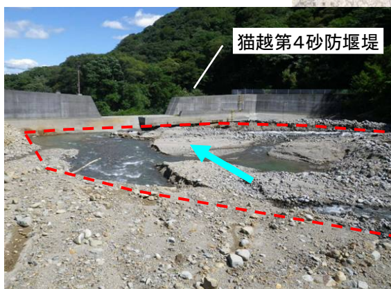
台風後(9月22日) 砂防堰堤上流の堆砂敷より撮影
