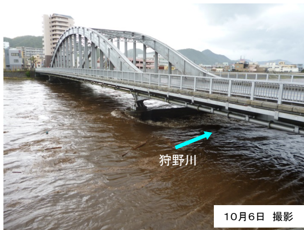
台風第18号による出水状況
