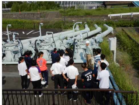
小坂排水機場の機能を学ぶ
