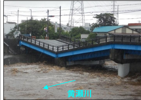
令和3年黄瀬川大橋被災
