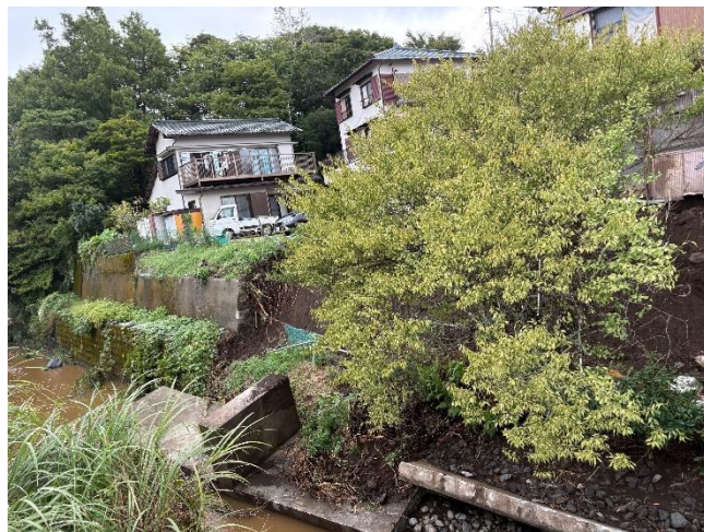
用沢川の護岸崩落(下和田:9月11日)
