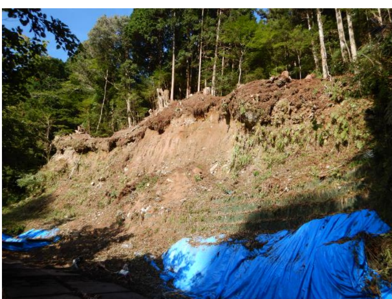
林地崩壊の発生
