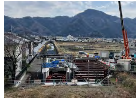
大平江川排水機場
