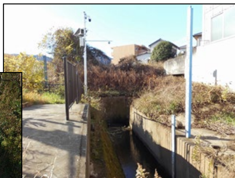
【樋管の内水側に設置した監視カメラ】
