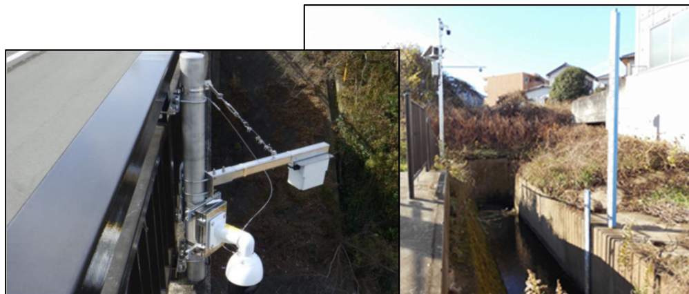
【監視カメラ/水位センサー設置状況】
