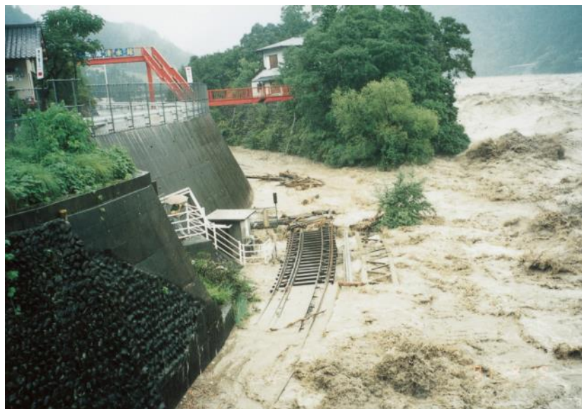
川根大橋上流右岸（平成3年9月 台風18号）
