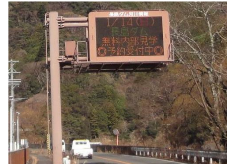
河川情報表示設備
