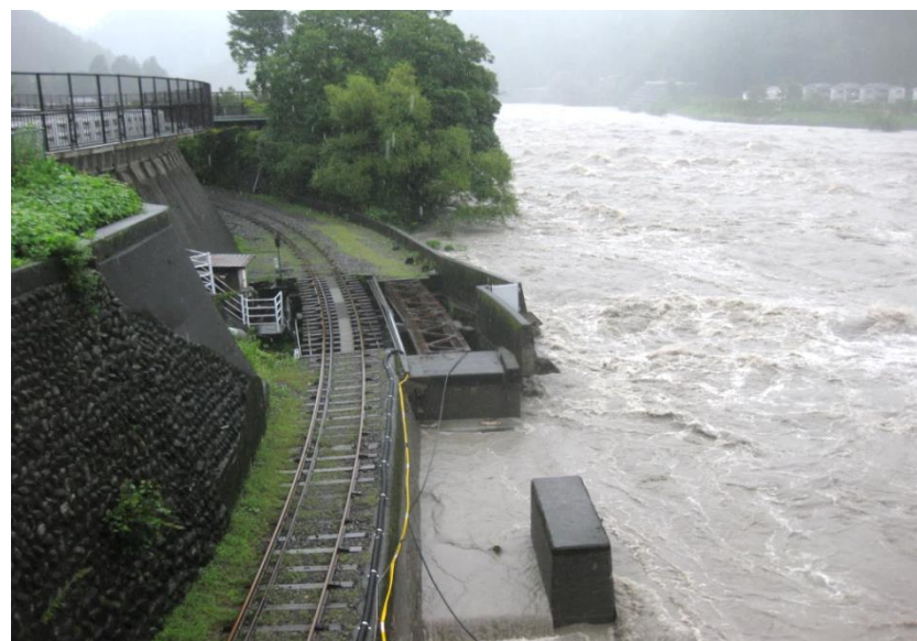
川根大橋上流右岸（平成23年9月 台風15号）
