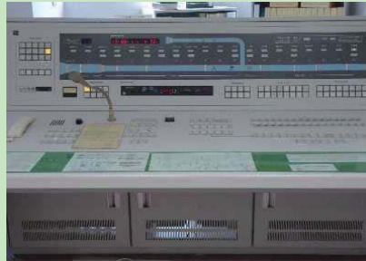
ほうりゅうけいほうせつび せいぎょそうち 放流警報設備制御装置
