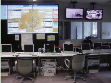
ほうりゅうせつびせいぎょそうち ダム放流設備制御装置 (ダムコントローラー)
