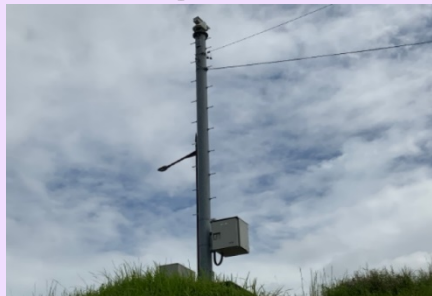
新両郡橋CCTV
