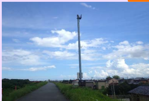
雲出橋観測所CCTV
