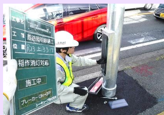
ブレーカーOFF時の状況
