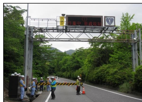
【沓掛ゲート】 昨年度の遮断機の操作訓練の様子
