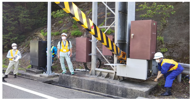
【沓掛ゲート】 遮断機の操作訓練
