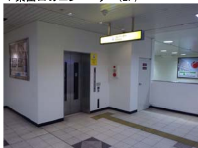
▼東出口のエレベーター(2F)
